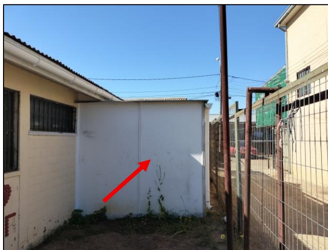
Imagen 3: La Laguna, muros exteriores de ampliación con pintura con asbesto en estado friable.
