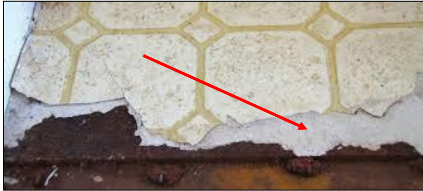
Imagen 19: Flexit de vinil asbesto con fieltro de papel de asbesto friable. 63
