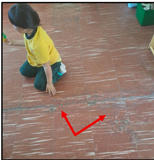
Figura 4: Exposición pasiva, párvulo sobre vinil asbesto con daño.
