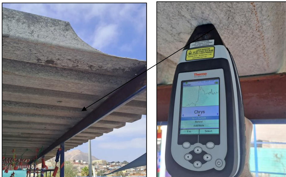
Imagen 6 y 7: Cubierta de asbesto cemento jardín infantil JUNJI, espectrómetro NIR.
